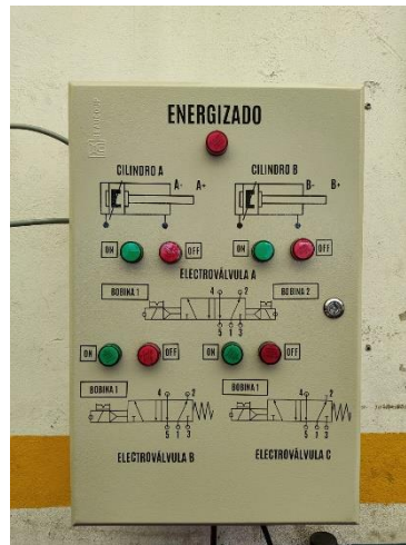
Figura 5. 8 Señalización de luz piloto.
