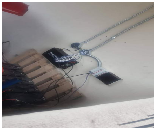
Fig. 20 Conexión del Regulador de Carga y el Banco de Paneles Solares
