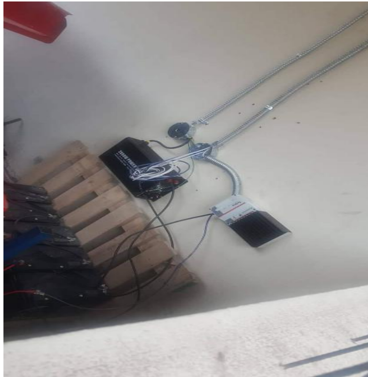
Fig. 23 Conexión entre el Banco de Baterías y el Inversor
