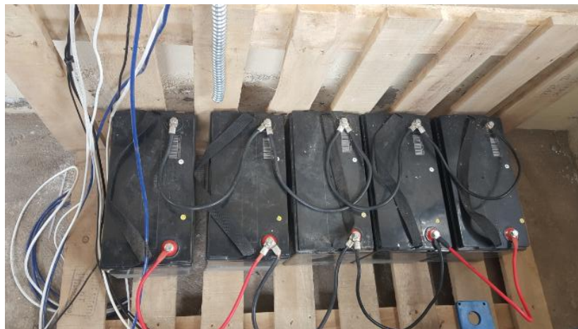
Fig. 21 Conexión del Banco de Baterías
