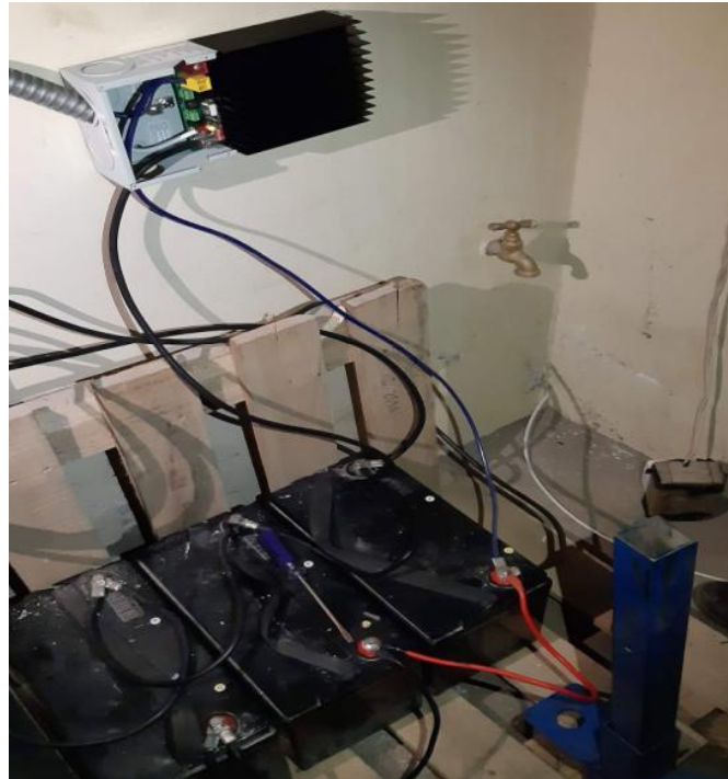
Fig. 22 Conexión entre Banco de Baterías y el Regulador de Carga
