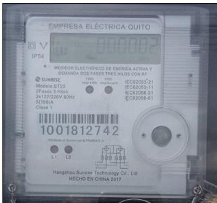
Figura 2. 7 Medidor Electrónico 2 Fases 3 Hilos con RF.
