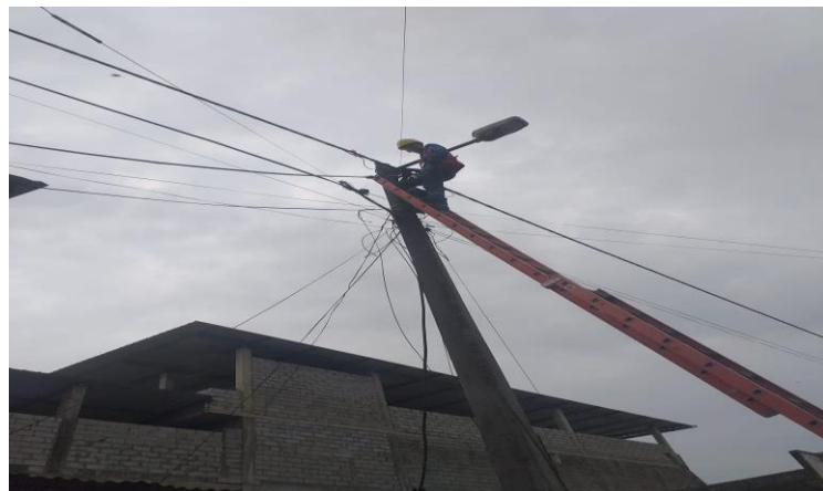
Figura 38: Instalación a red de transmisión de bajo voltaje
