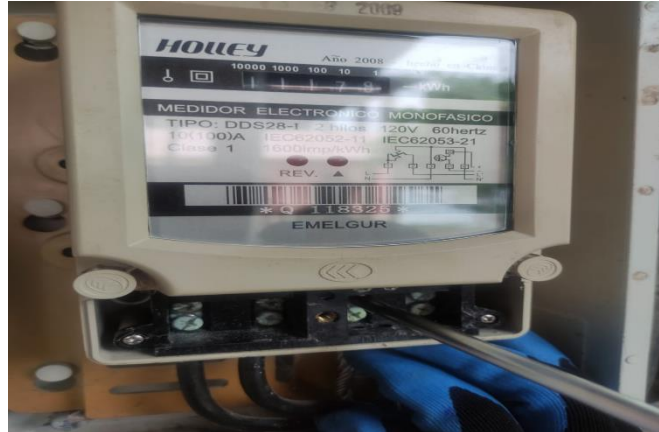
Figura 35: Conexión de borneras a medidor monofásico
