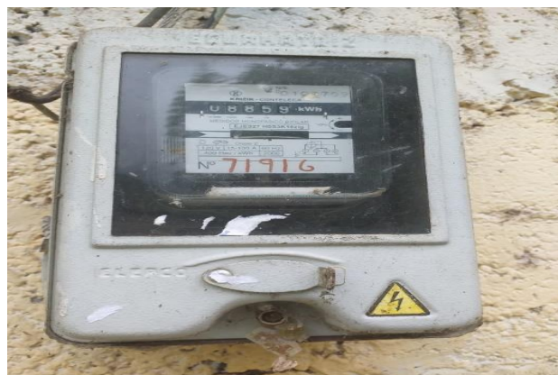
Figura 10: Medidor monofásico bifilar
