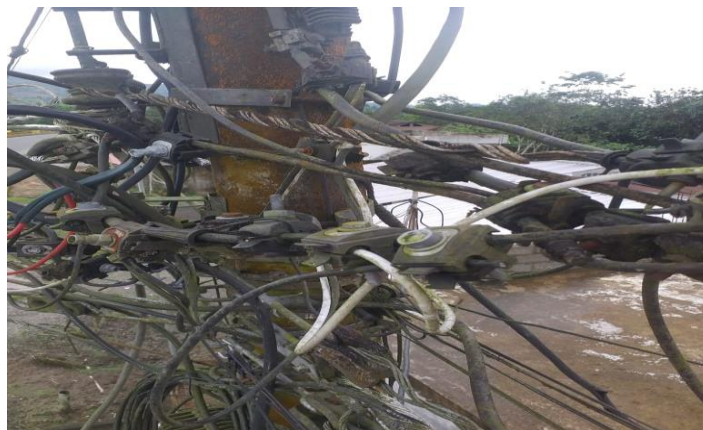
Figura 36: Vista de los conectores de líneas y neutros
