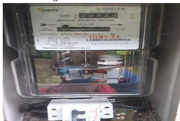
Figura 12: Medidor bifásico trifilar
