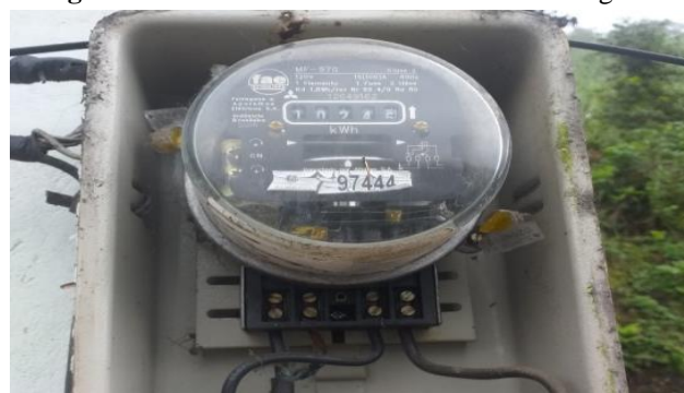
Figura 8: Contadores electromecánicos o analógicos
