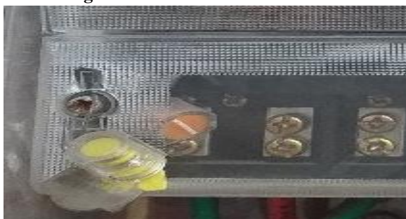
Figura 25: Sello medidores de cables
