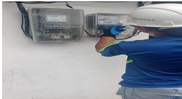
Figura 42: Comprobación de las líneas salientes
