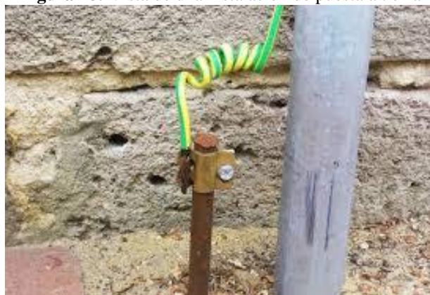
Figura 18: Vista de una instalación de puesta a tierra
