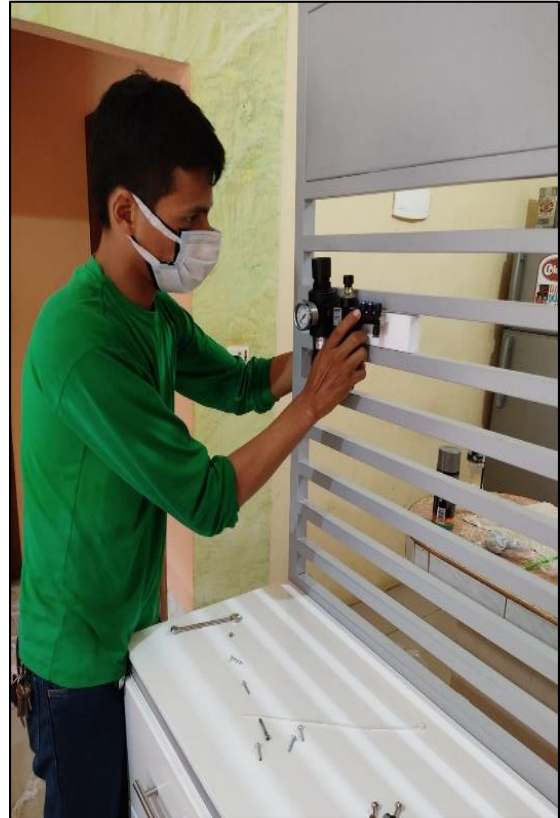
Imagen 4: Instalación de unidad de mantenimiento
