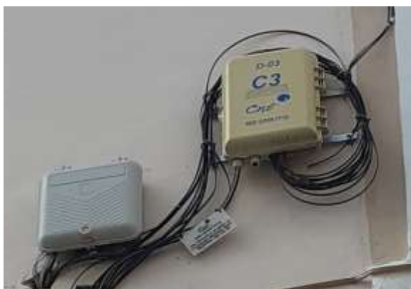
Imagen 36 Caja de conexión del cable drop
