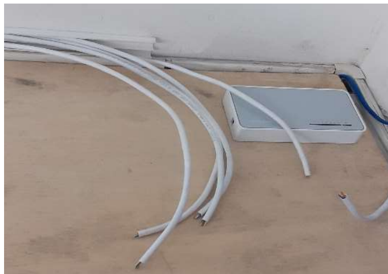
Imagen 89 Switch de conexión TP-Link
