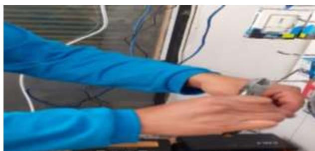
Imagen 71 Corte del cable drope
