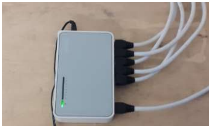
Imagen 91 Conexiones de cable UTP al switch
