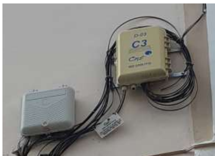
Imagen 69 Caja de distribución de la fibra óptica
