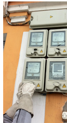
Instalación en tableros independientes
