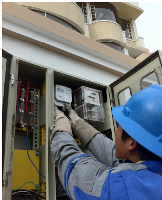
Instalación en un tablero general
