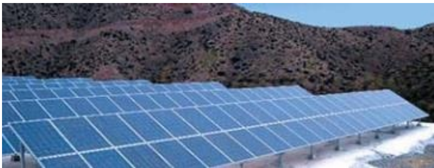
Fig. 1. Aprovechamiento de energía fotovoltaica.
