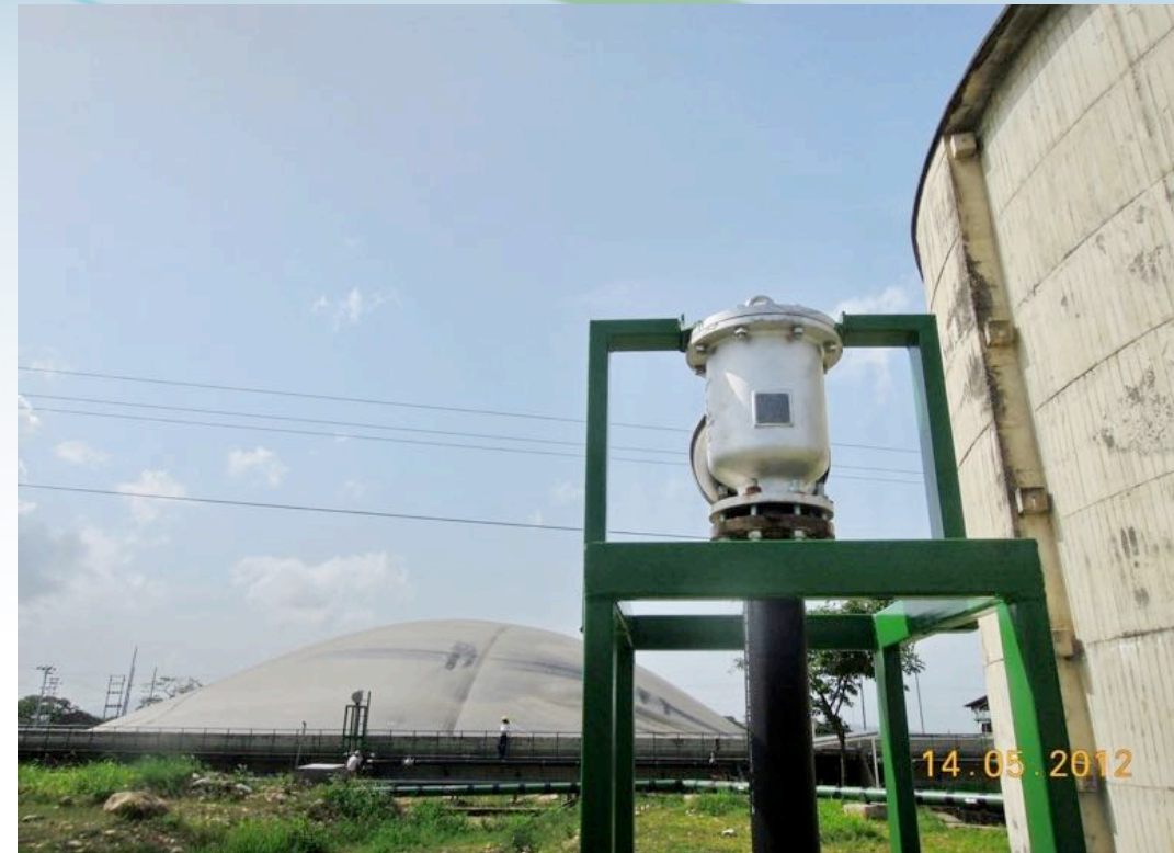
Válvula de seguridad en biodigestor en Venezuela
