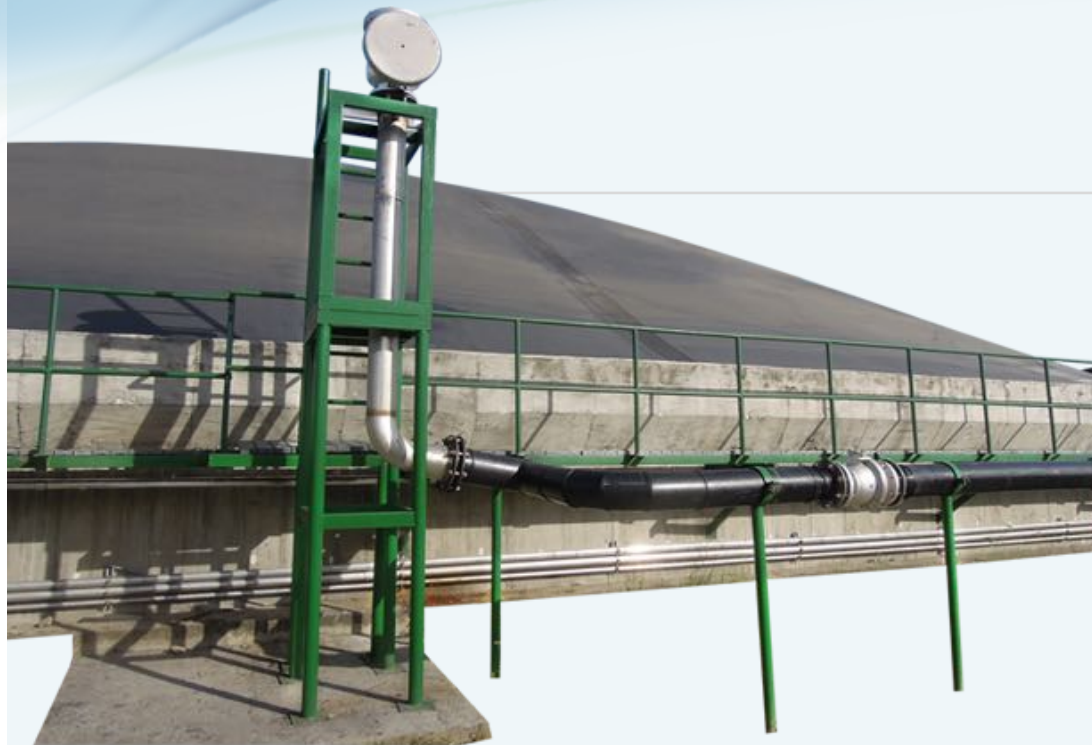
Válvula de seguridad en reactor UASB en Venezuela
