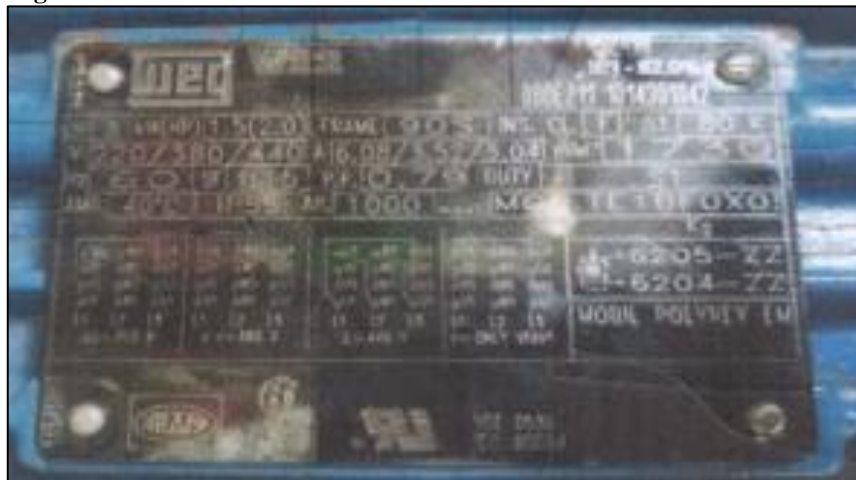
Figura 33: Placa de funcionamiento del motor utilizado
