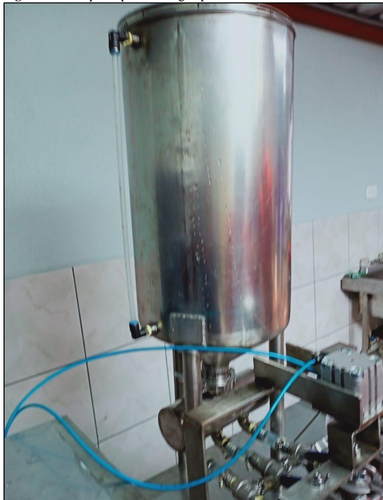
Figura 27. Tanque depósito de agua purificada
