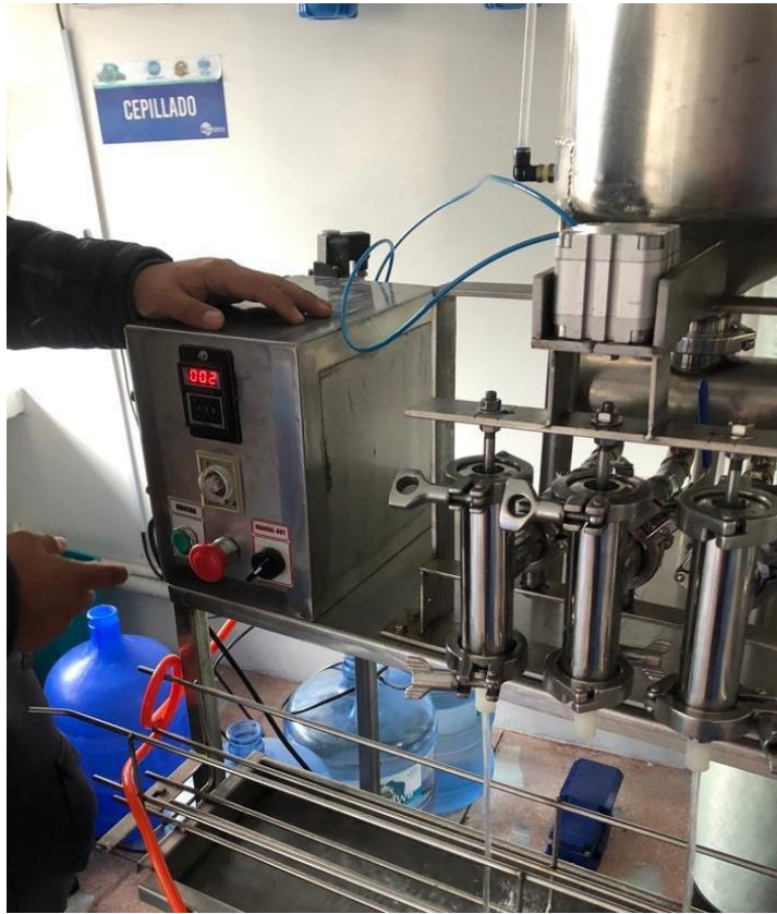
Figura 34. Sistemas electromecánicos integrados en la embotelladora de agua
