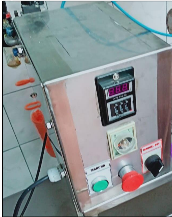
Figura 30. Tablero de control
