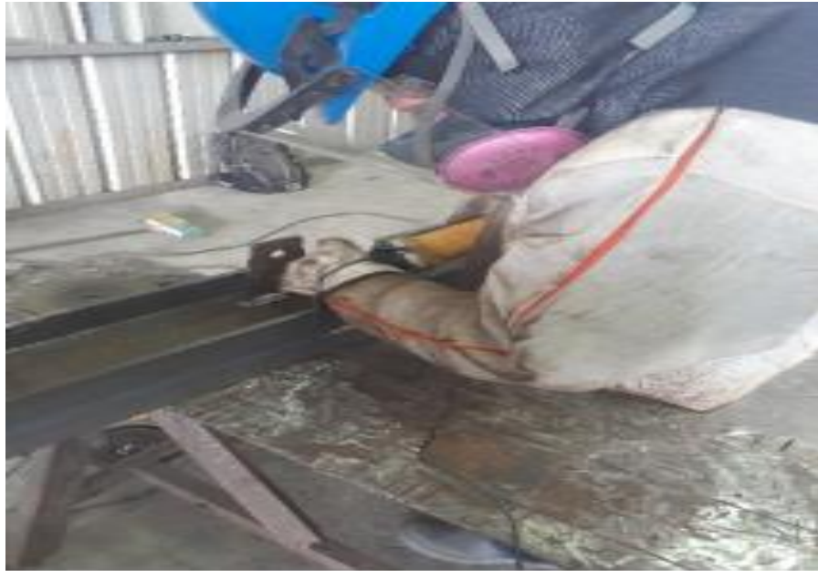
Monitoreo de vibración mano brazo – P7: Motortool fresa línea de armado 3
