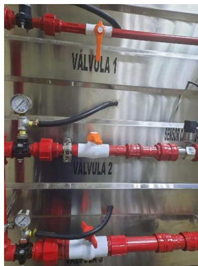
Figura. 28: Cierre de válvulas
