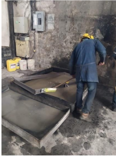
Figura 3.12. Proceso de fosfatizado GREAT CONTAINER, (1)
