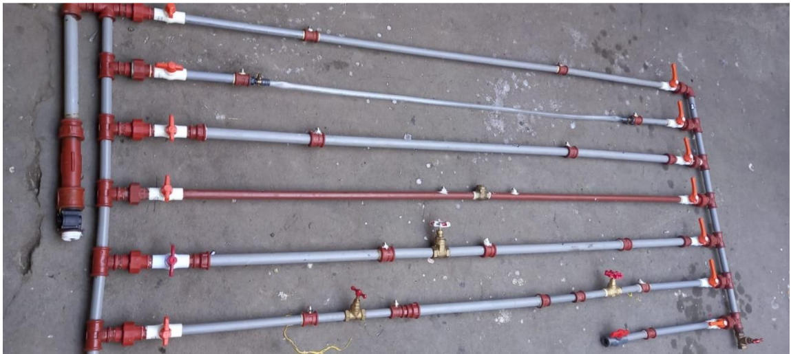
Figura E.3. Conexión de 7 tramos de diferentes diámetros de tuberías con sus respectivos accesorios y acoples.
