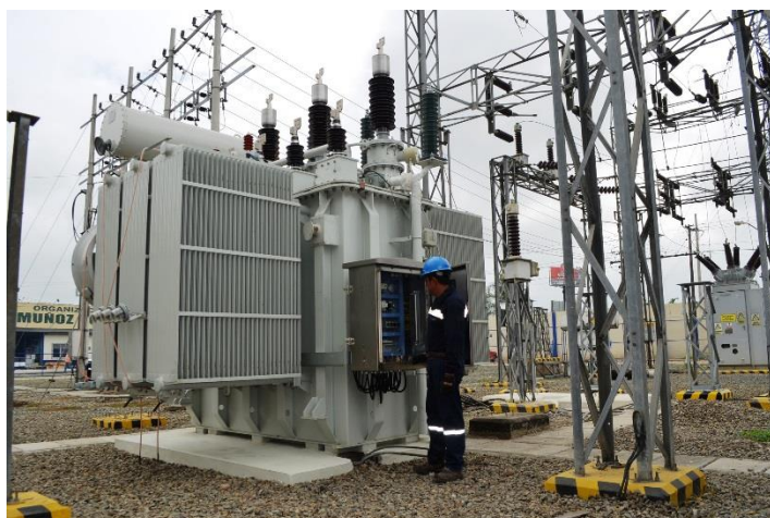
Figura 5.2. Subestación El Calvario [12].
