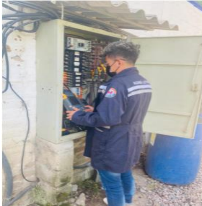
Figura I.1. Conexión del analizador de redes trifasico en el tablero principal.
