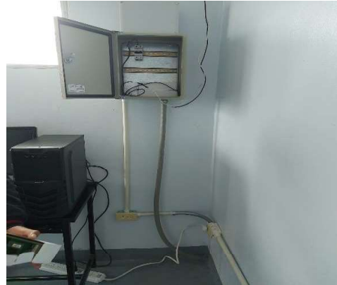
Fotografía C.8: Conexión del sistema Fuente: Carrera de Electromecánica
