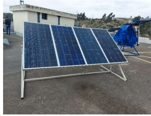
Fotografía C.2: Planta Fotovoltaica Fuente: Carrera de Electromecánica
