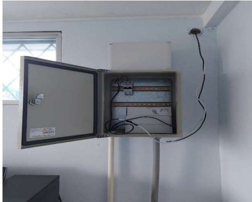
Fotografía C.7: Armario flotante para equipos Fuente: Carrera de Electromecánica
