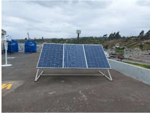
Fotografía C.1: Paneles fotovoltaicos Fuente: Carrera de Electromecánica
