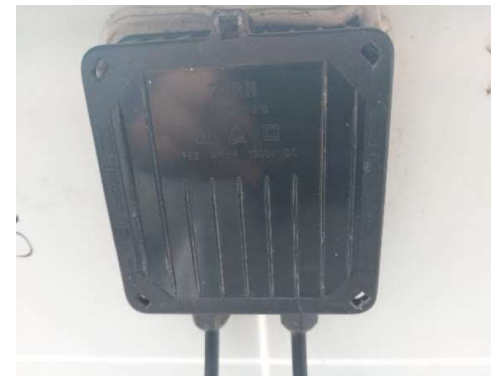
Fotografía C.6: Caja de In/Out Inversor Fuente: Carrera de Electromecánica
