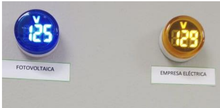
Figura 4 Voltímetros y señalización
