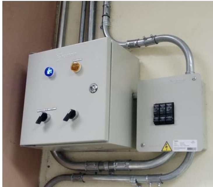
Figura 4.12 Nuevo tablero de transferencia de energía.
