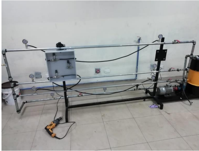
Figura 3. Montaje de sensores.
