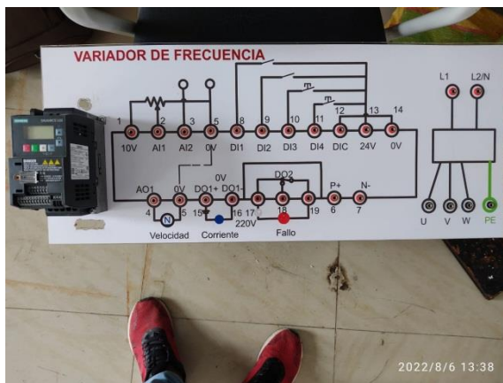
Imagen 17: Cableado del variador de frecuencia
