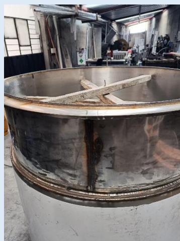
Soldadura completa del tanque y el soporte de la lana de vidrio
