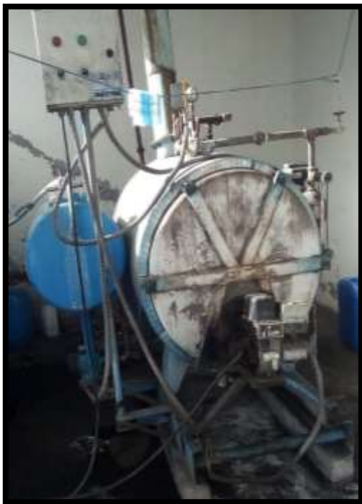
Caldero para Pasteurizar la leche
