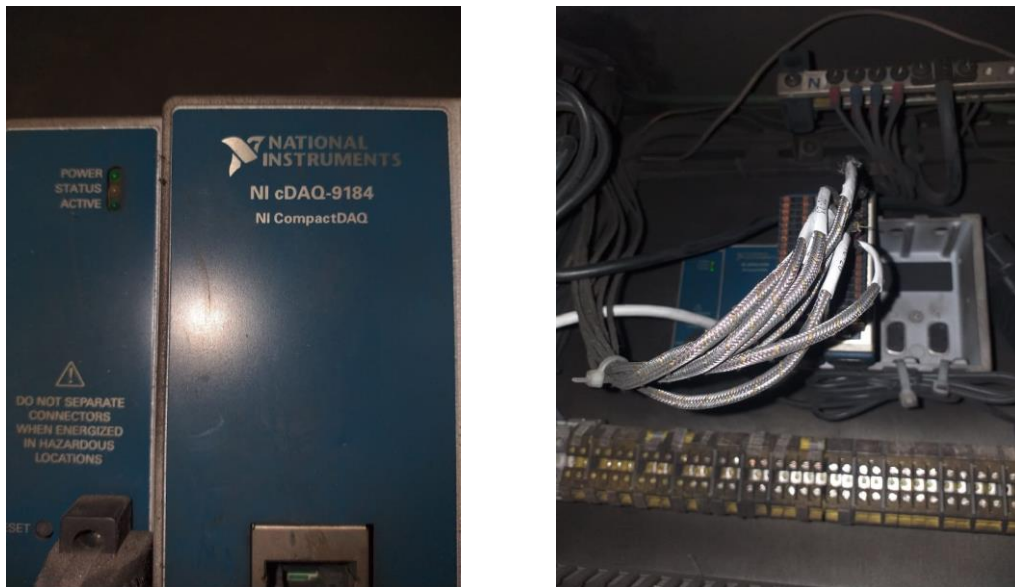
Figura 3.24. Conexión cable termopar al módulo NI 9205
