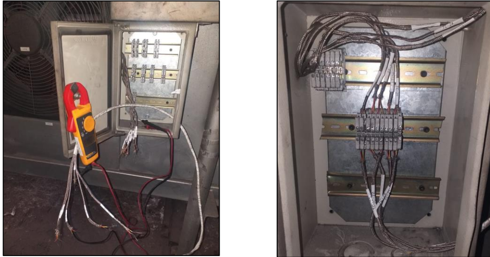
Figura 3.25. Denominación del cable termopar en el gabinete eléctrico
