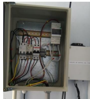
Fotografía C.6: Gabinete Fuente: Carrera Ing. Electromecánica
