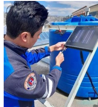
Fotografía C.11: Instalación del Data sol Met. Fuente: Carrera Ing. Electromecánica
