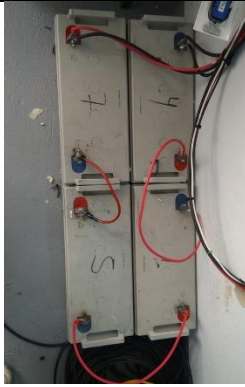
Fotografía C.7: Banco de baterías 6-CNJ-120 Fuente: Carrera Ing. Electromecánica
