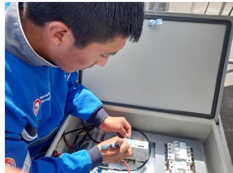
Fotografía C.13: Conexión de la fuente de 24V Fuente: Carrera Ing. Electromecánica
