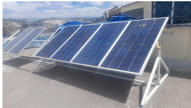
Fotografía C.2: Planta Fotovoltaica Fuente: Carrera Ing. Electromecánica
