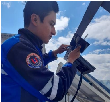
Fotografía C.12: Instalación del Sensor de temperatura pt100 Fuente: Carrera Ing. Electromecánica
