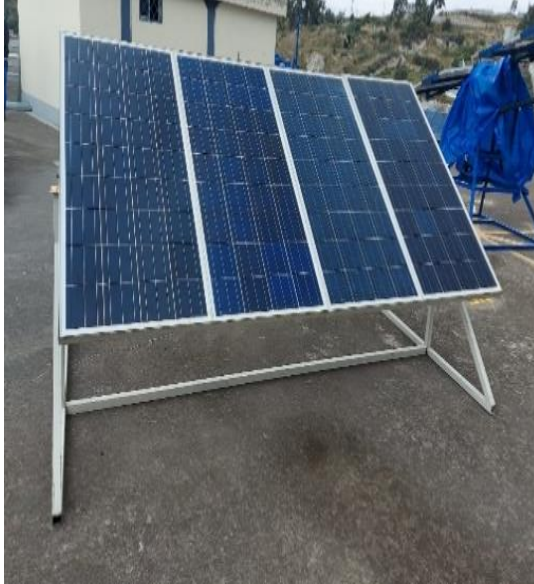
Fotografía B.1: Planta fotovoltaica Fuente: Carrera de Electromecánica
