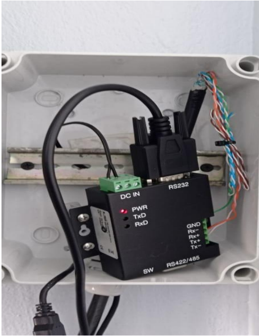
Fotografía C.13: Conexión de los inversores. Fuente: Carrera de Electromecánica.
