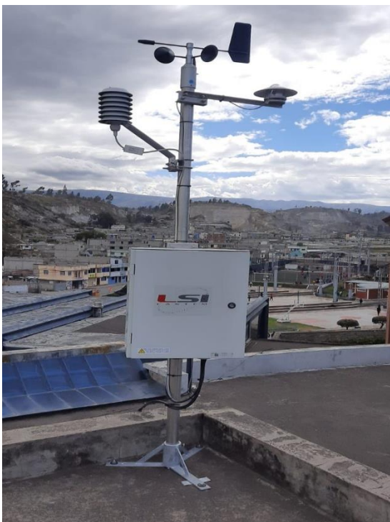
Fotografía B.7: Verificación de la conexión de los sensores. Fuente: Carrera de Electromecánica
