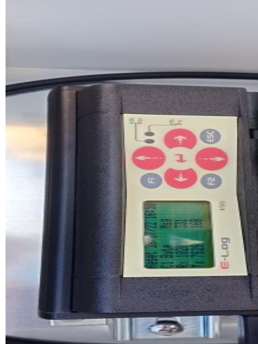
Fotografía C.10: Verificación del encendido de la pantalla.
