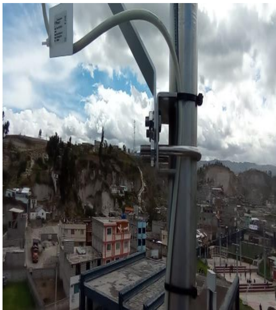
Fotografía B.5: Instalación del sensor de Termo higrómetro Fuente: Carrera de Electromecánica
