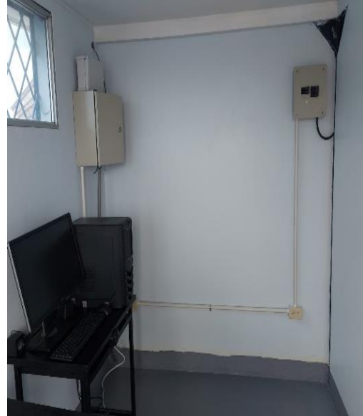
Fotografía B.2: Conexión al computador Fuente: Carrera de Electromecánica
