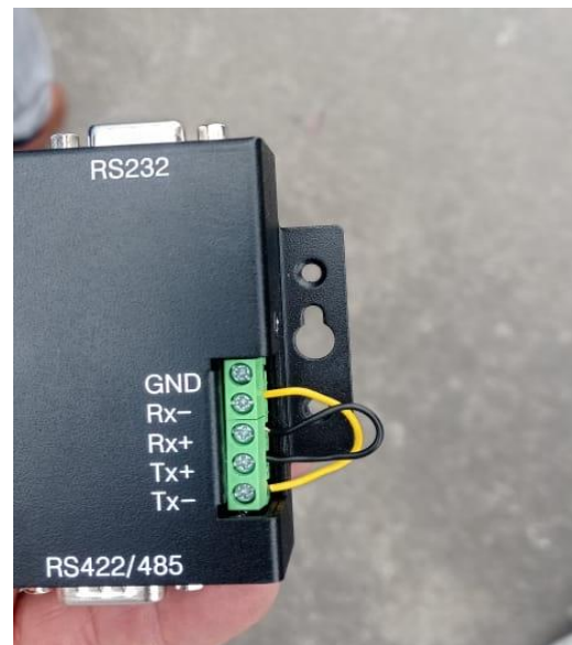
Fotografía C.12: La conexión del terminal de los pines de salida
