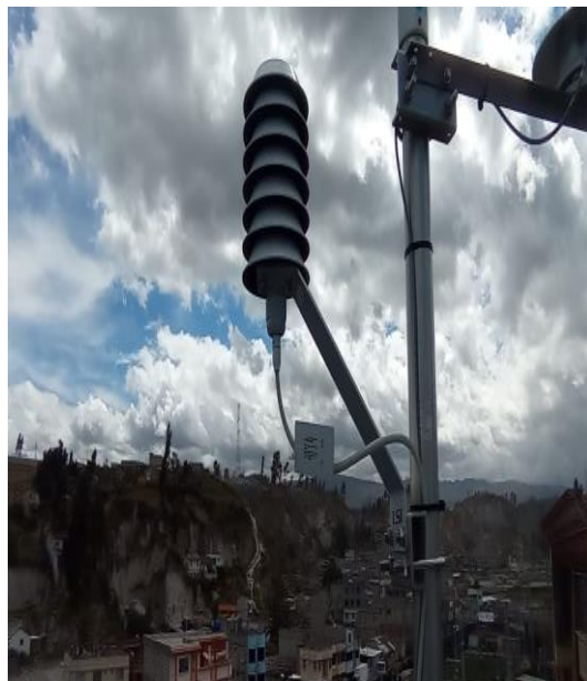
Fotografía B.6: Verificación de la ubicación exacta del equipo Fuente: Carrera de Electromecánica
