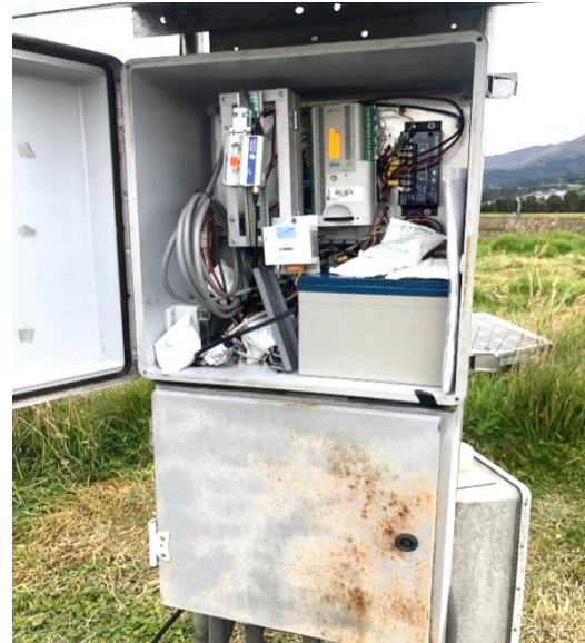
Gabinete que contiene datalogger, logger, módem gprs, batería, controlador de caraca.
