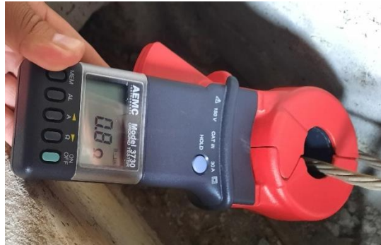
Fig. 32. Medición de la Puesta a Tierra
