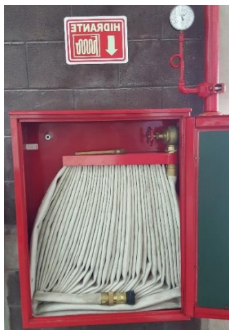
Figura 2.7. Gabinete de extinción de incendios.
