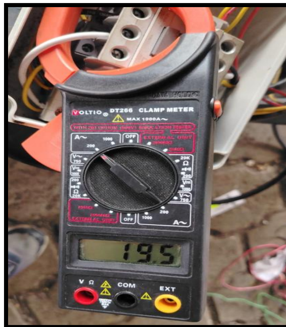
Figura 5-14: Medición de corriente de operación de choque
