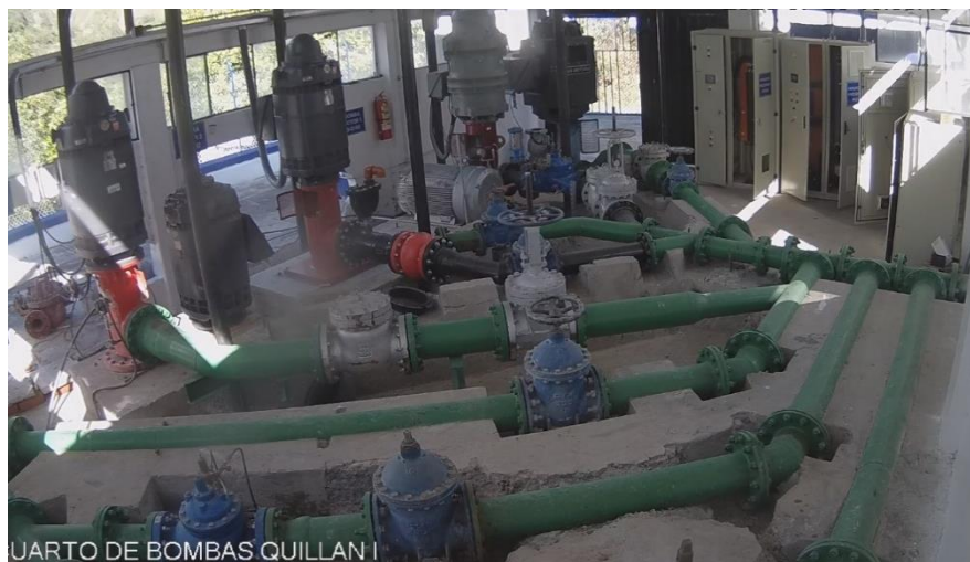
Figura 23 Cuarto de máquinas Quillán 1.
