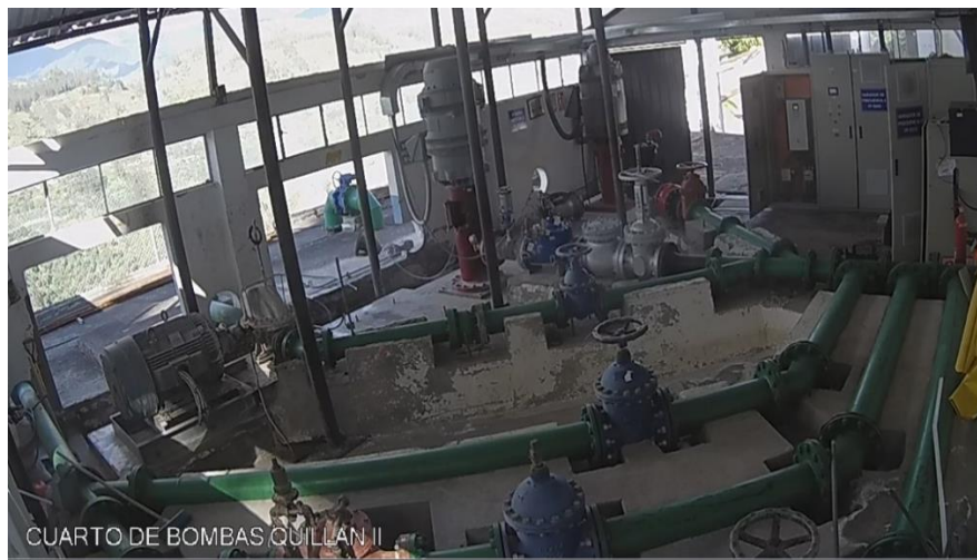
Figura 24 Cuarto de máquinas Quillán 2.
