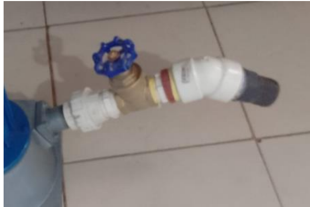
Figura 25. Conexión del flujo de caudal a la turbina.
