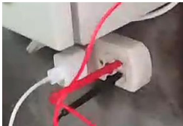
Figura 28. Tomacorriente instalado con una carga de 10 W.
