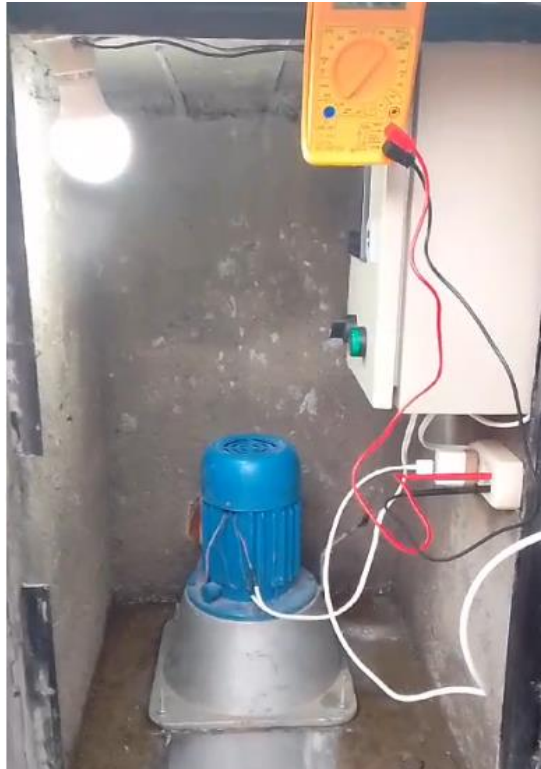
Figura 29. Conexión eléctrica completa.
