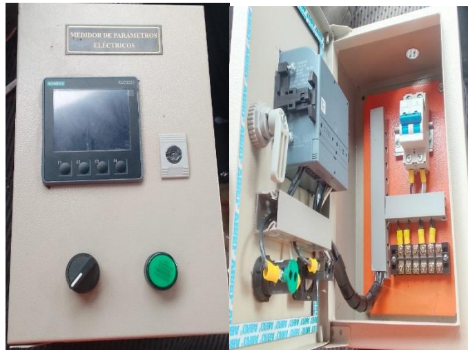
Figura 27. Panel de control.
