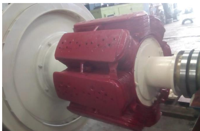
Figura 21. Rotor con buen nivel de aislamiento >20000 MΩ
