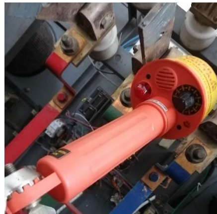
b) Barras sin voltaje
