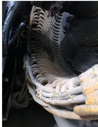
Figura 17. Estado físico de los bobinados.
