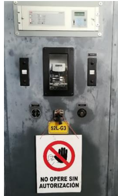
Figura 12. Etiquetado y bloqueo del disyuntor.
