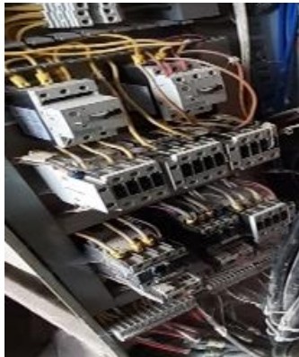
(b) Circuitos eléctricos fotografía
