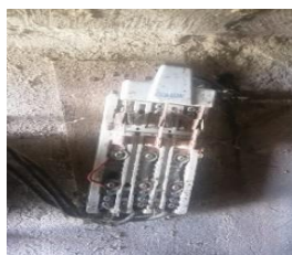
Figura 4.2 Protección eléctrica obsoletas
