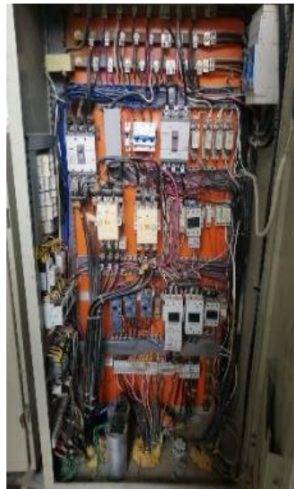
(b) Tablero eléctrico libre de suciedad.
