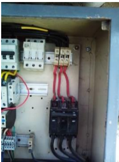
a) Interruptor termomagnético
