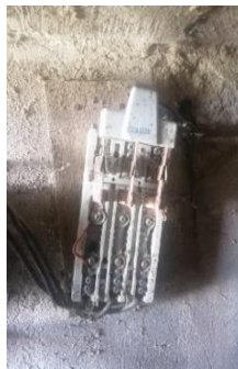
Figura 1. Protección eléctrica no adecuada.
