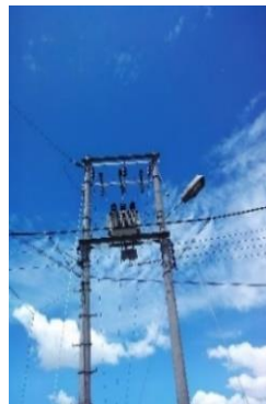
Figura 4.3 Transformador ELEPCO T402 de 75 kVA [40].
