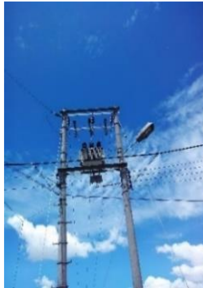
Figura 2. Transformador ELEPCO T402 de 75 kVA [40].
