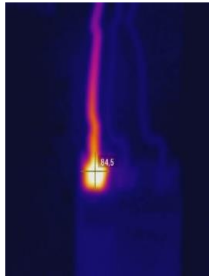
b) Termografía en la protección del tablero 2
