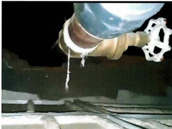
FIGURA 3.1 UNIÓN DE TUBERÍA PRINCIPAL Y SECUNDARIA POR MEDIO DE LA LLAVE DE PASO
