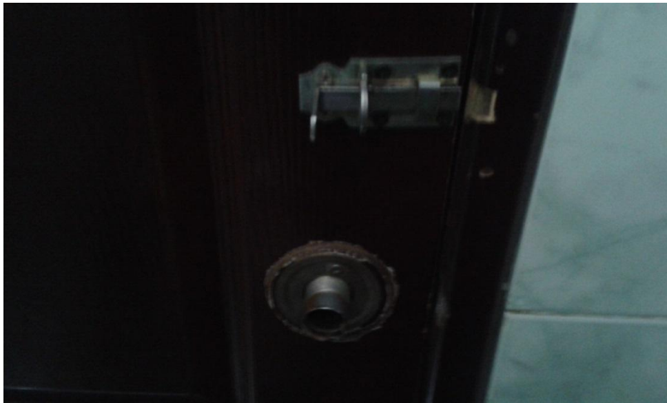
Plaza Sucre – Puertas en mal estado
