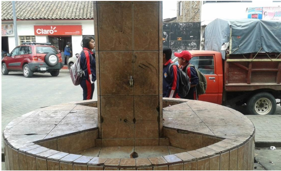
Plaza Sucre- Tomas de agua Insalubres y deterioradas
