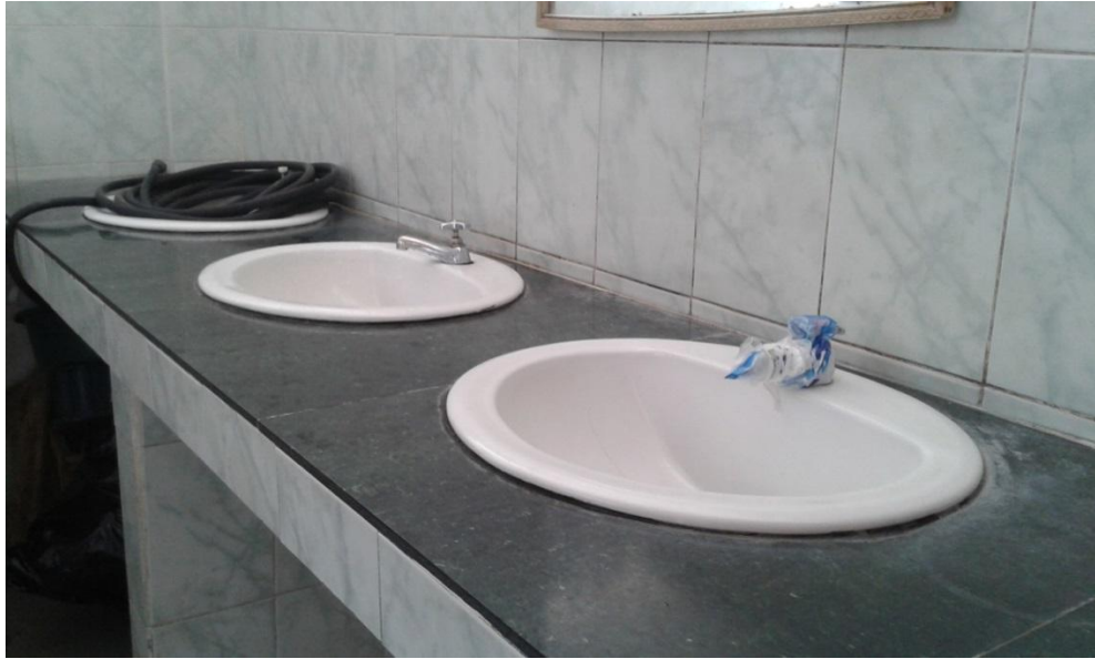
Plaza Sucre – Lavamanos dañados
