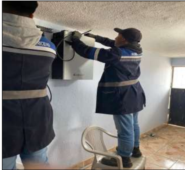
Figura. 37 Instalación del banco de baterías en el área designada.
