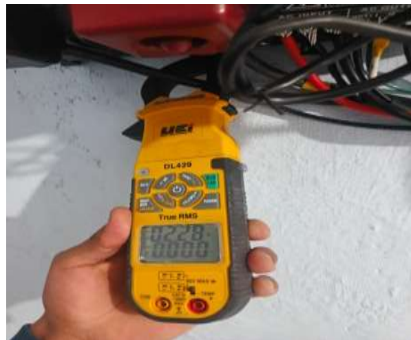
Figura. 58 Valor medido de la corriente de banco de baterías.
