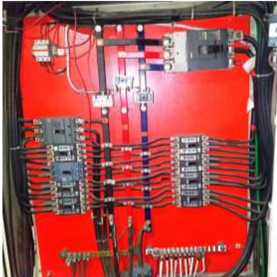
Figura. 11 Tablero de distribución principal.
