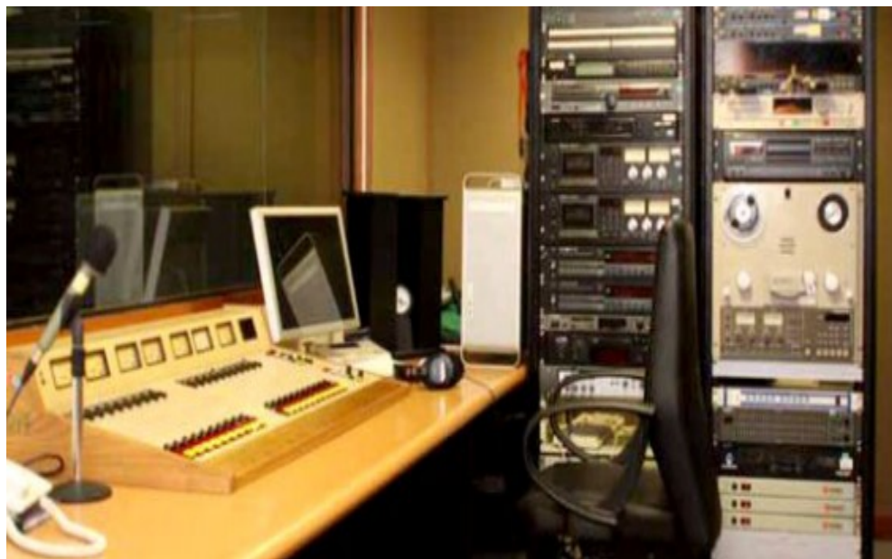
CABINA DE CONTROL
