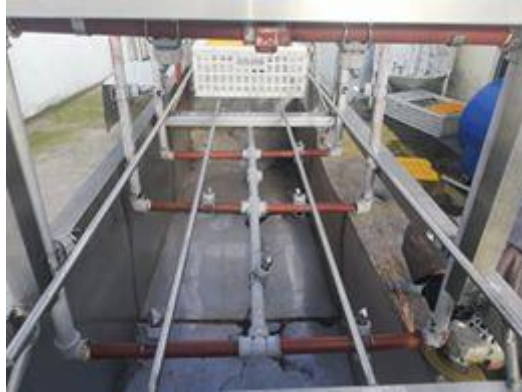
Figura 1. sistema de Tuberías una lavadora de jaulas de pollos.
