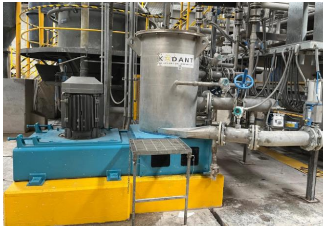
Figura 5.10. Screen One instalado en la planta
