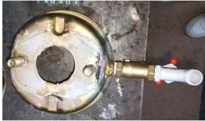
Figura 36. Implementación de válvulas
