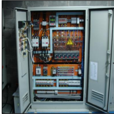
Figura 3. 2. Tablero eléctrico con transferencia
