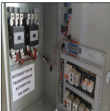
Figura 3. 4. Tablero de transferencia automático
