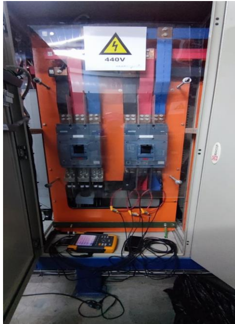
Figura 4. 7 Instalación del analizador de red después del filtro de red en la Empresa
