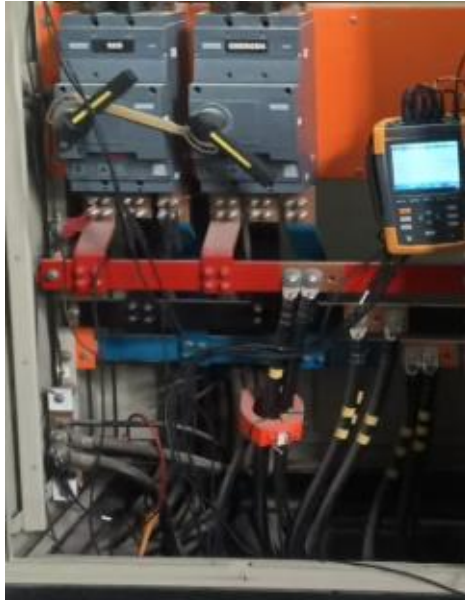
Figura 4. 8 Instalación del analizador de red antes del filtro de red en la Empresa
