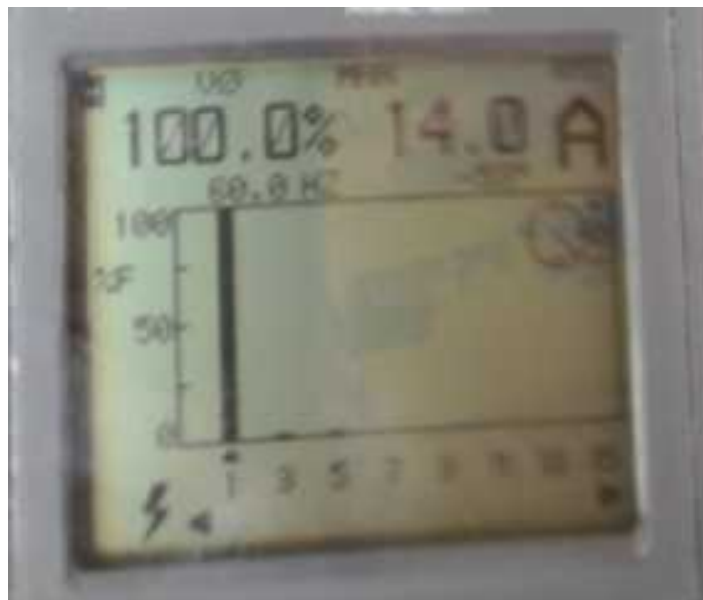
Fotografía 4.2. Armónicos en el encendido de la cisterna
