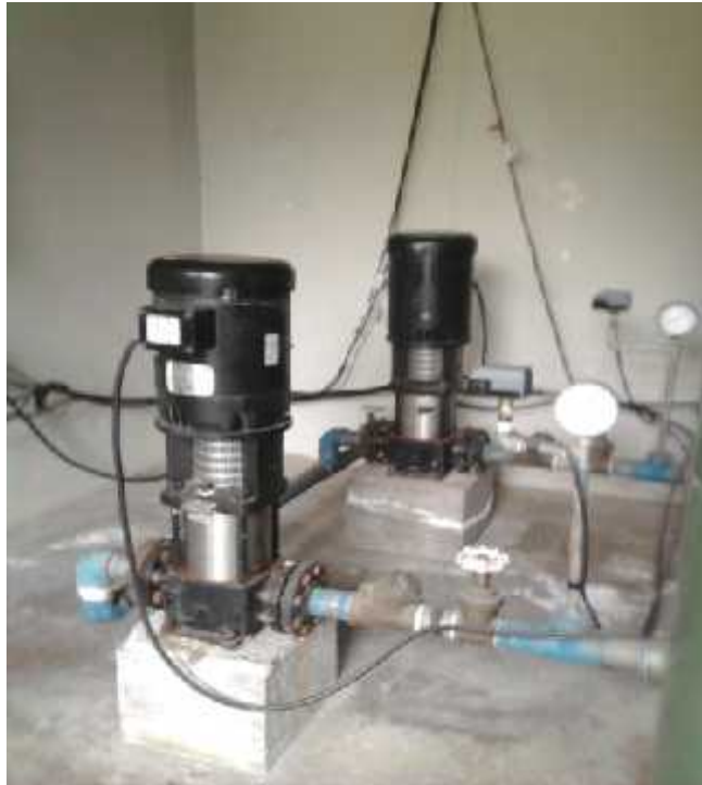
Fotografía 4.1. Bombas de la cisterna
