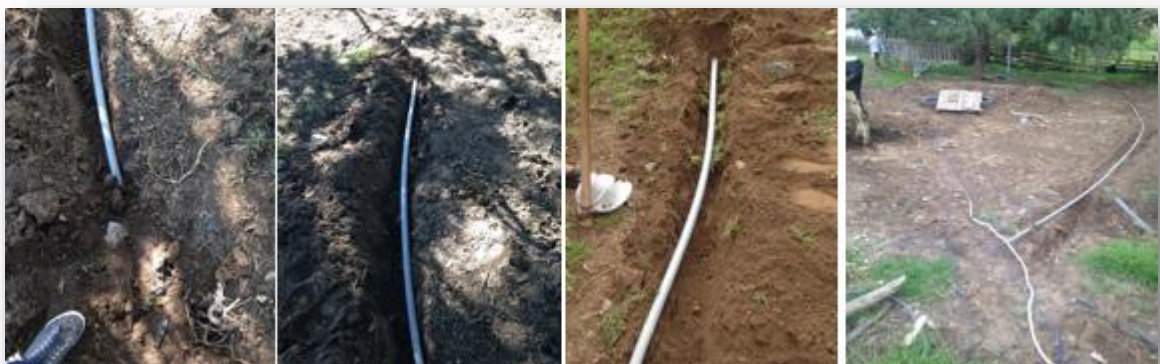
Figura 4-21: Cableado para sistema automático Fuente: Suárez R. (2015)
