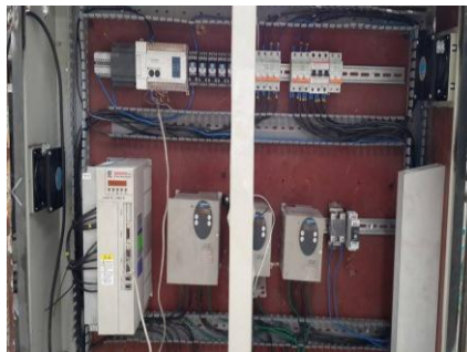
FIGURA 3. 28 Armario eléctrico con los elementos
