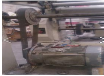
FIGURA 3. 19 Banda del sistema de la cama
