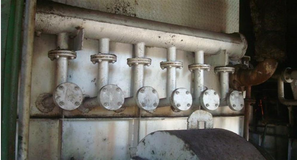
Figura 24: Las tuberías de agua caliente y agua condensada
