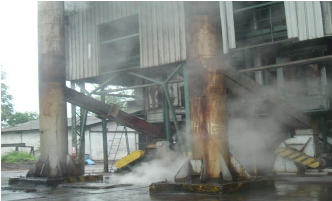
Figura 25: Tuberías de aceite, diésel y purga de escape
