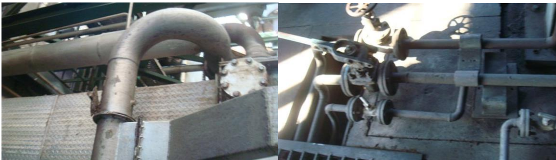
Figura 23: Las tuberías de vapor y de agua fría.
