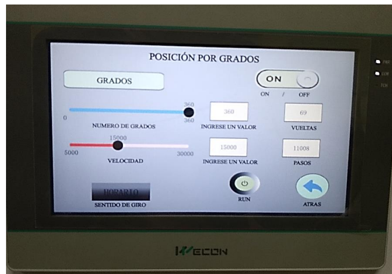
Figura 5.55. Datos ingresados en Pantalla HMI Wecon
