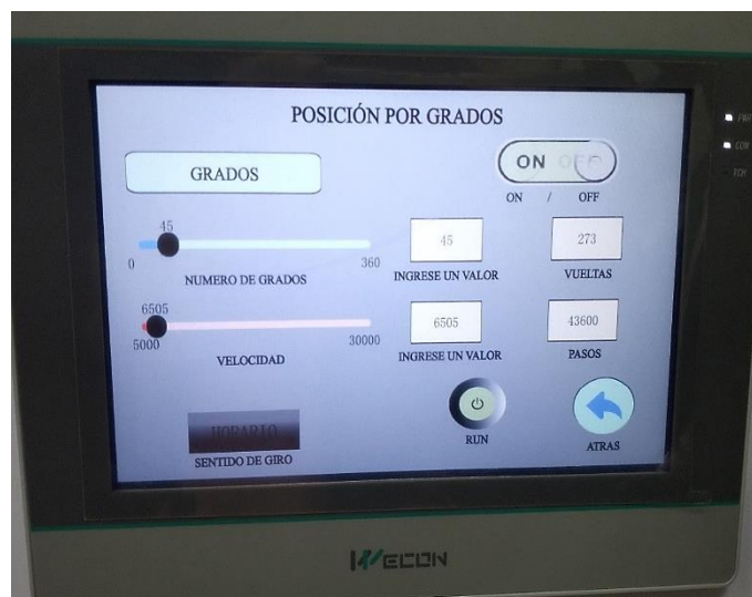
Figura 5.53. Pantalla HMI Wecon en posición de grados
