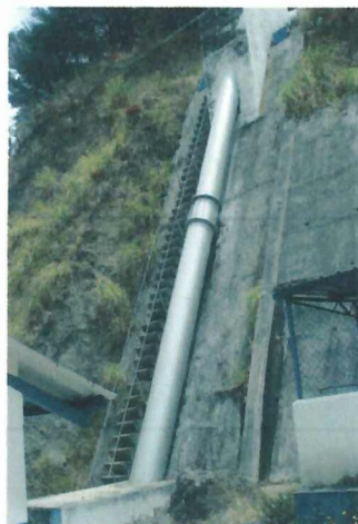
Figura 2.11 Tubería de presión
