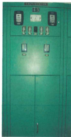
Figura 2.18 Tablero de sincronización
