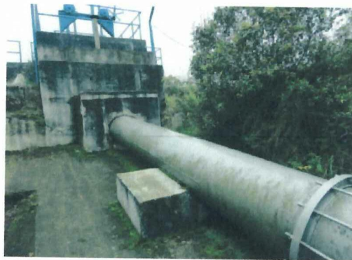
Figura 2.9 Conducto de baja presión
