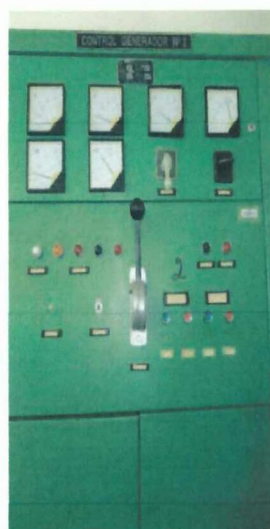
Figura 2.17 Tablero de control del generador 2.
