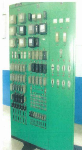
Figura 2.20 Tablero de protecciones del grupo turbina – generador
